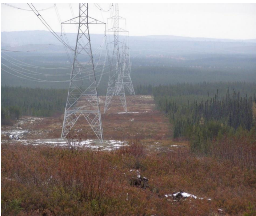
Figure 6 - Ligne électrique au site Rose
