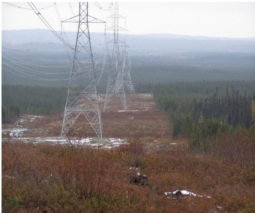
Figure 6 - Ligne électrique au site Rose
