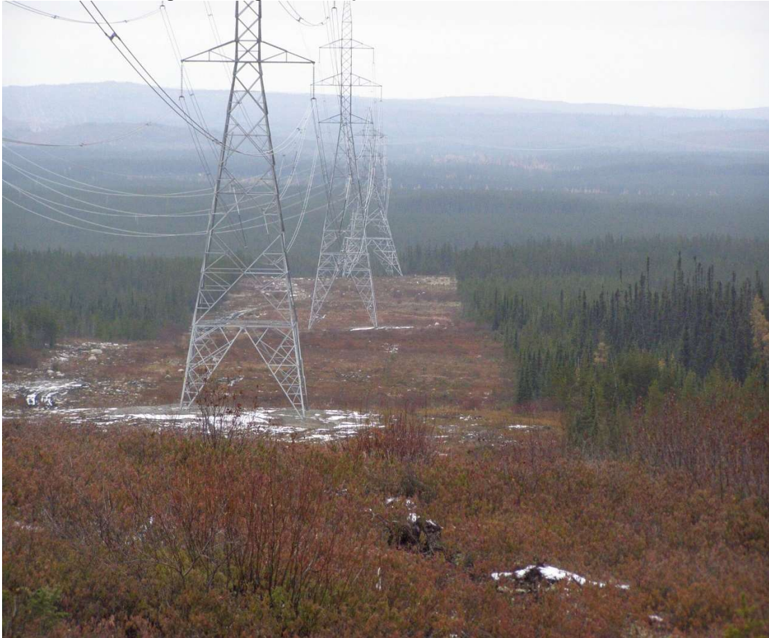
Figure 6 - Ligne électrique au site Rose lithium-tantale
